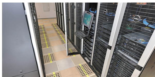
クラウドサーバ室
