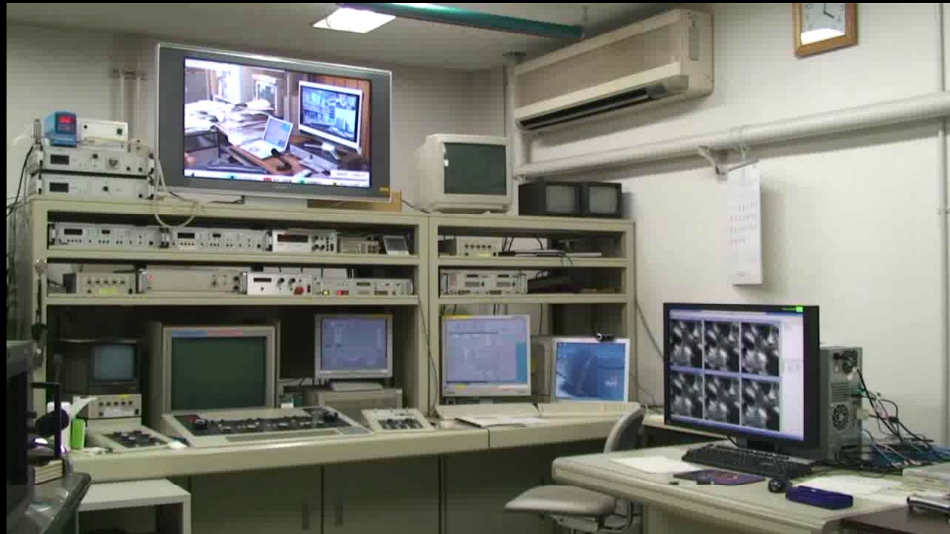
本体側操作室
